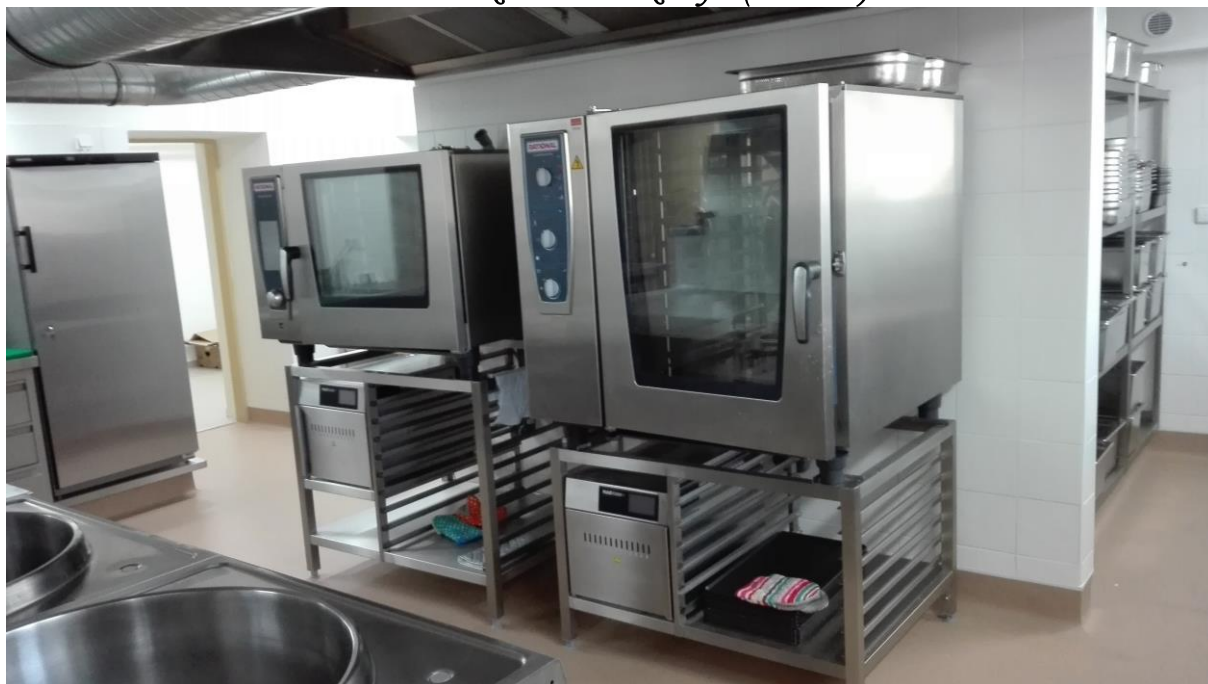
Zařízení rekonstruované kuchyně (září 2018)
